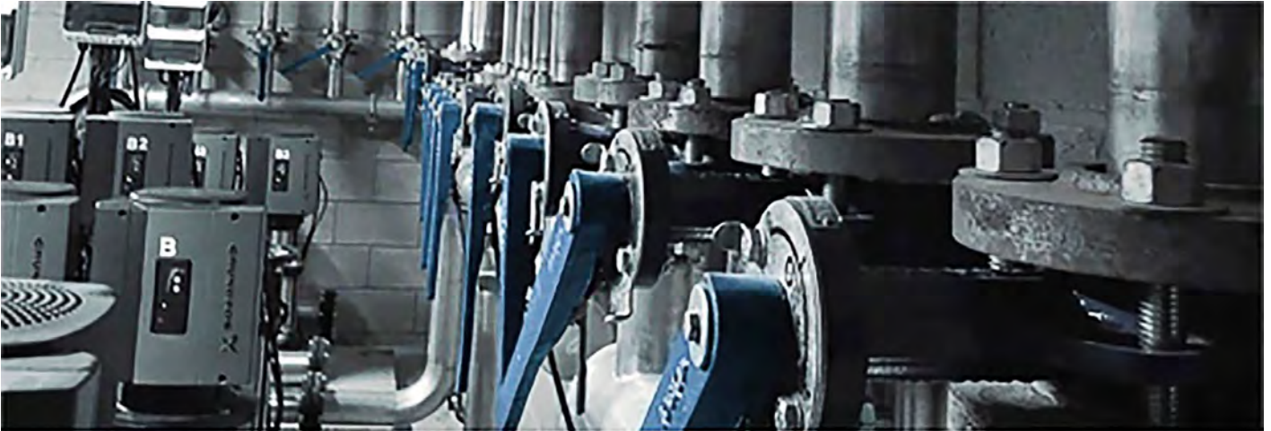
Technische ruimte watervoorzieningsbedrijf in een commercieel gebouw.
